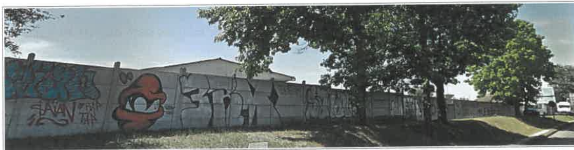
Figure 26 : Dégradation de la clôture coté D520
