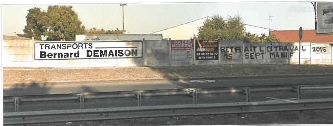
Figure 25 : Dégradation de la clôture coté D520
